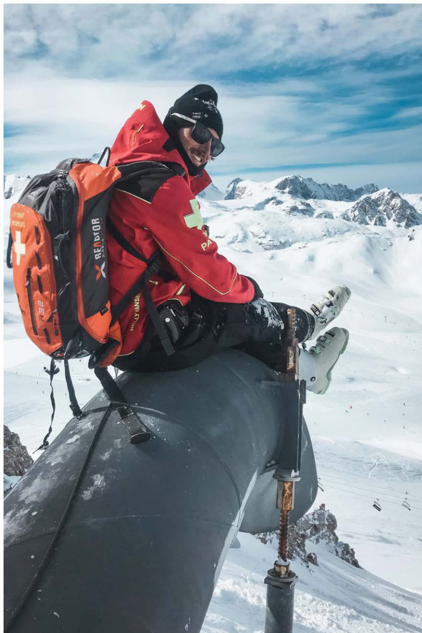
Entretien Gazex du râtelier en bois en amont de la Orange sur Bellevarde, Val d'Isère © Paul Gate
